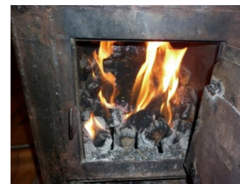
Рисунок 1 – Горение брикетов в топке водогрейного котла
