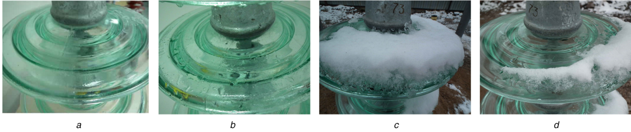
Fig. 1 Glass insulator images (a) Clean, (b) Water, (c) Snow, (d) Ice
